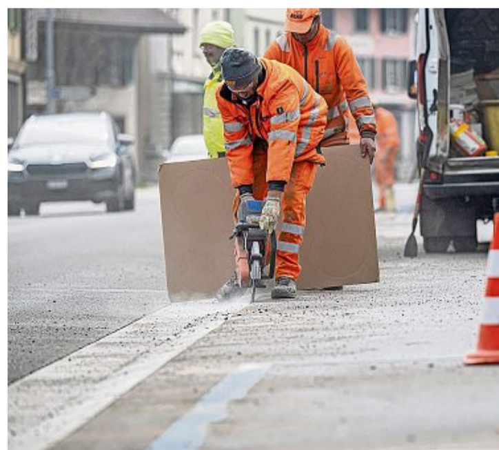
Noch bis Ende nächste Woche werden auf der Kantonsstrasse in Huttwil die Fugen erneuert. Foto: Marcel Bieri
